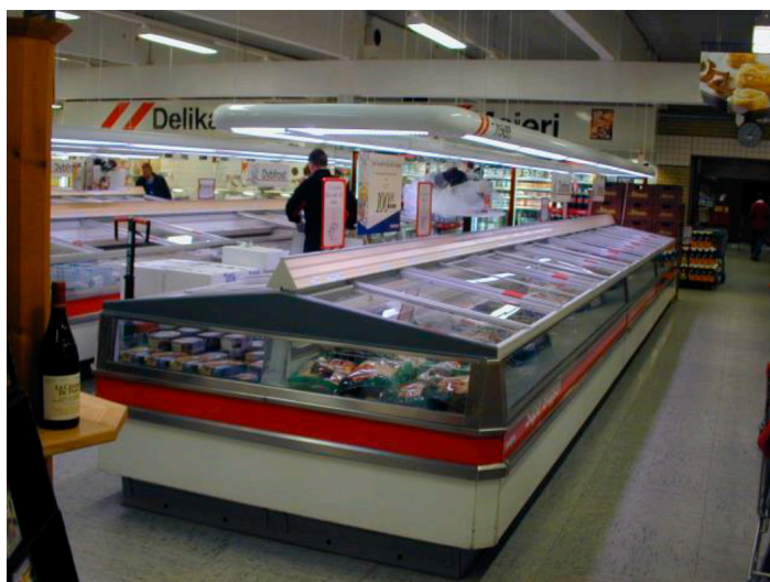
Figur 17. Permanent afdækning med glaslåg
