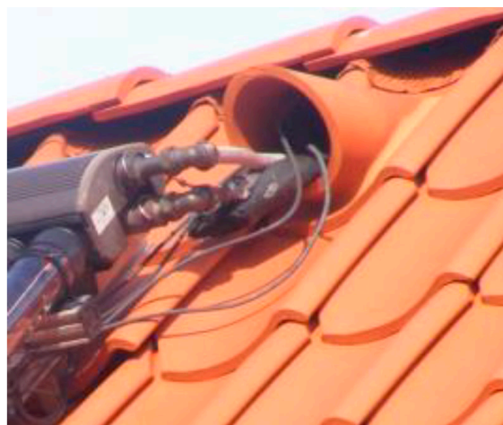
Figur 9. Kabler gennem tudsten (Foto: Teknologisk Institut)
